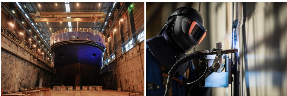
Рис. 5 Сварочные работы при сборке блок-секций ледокола по технологии сварки в узкую разделку разработки компании Kemppi с использованием оборудования, также разработанного в Kemppi: системы A5 MIG Rail System 2500 и источника питания FastMig M 520 power. Иллюстрации: Верфь Arctech Helsinki Shipyard.
